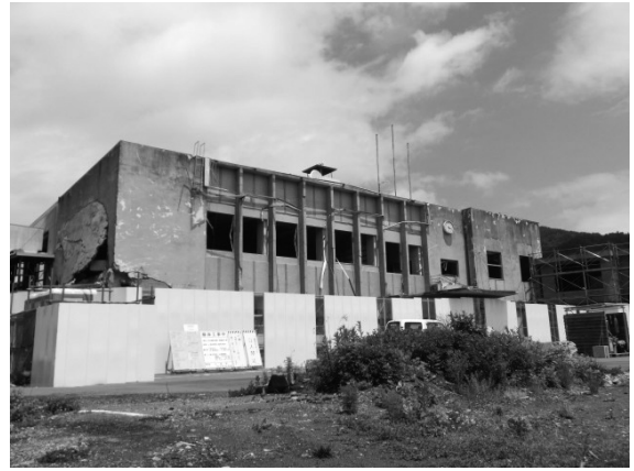
被災した大槌町役場。町長が変わり、震災遺構としての存続が危ぶまれている。
